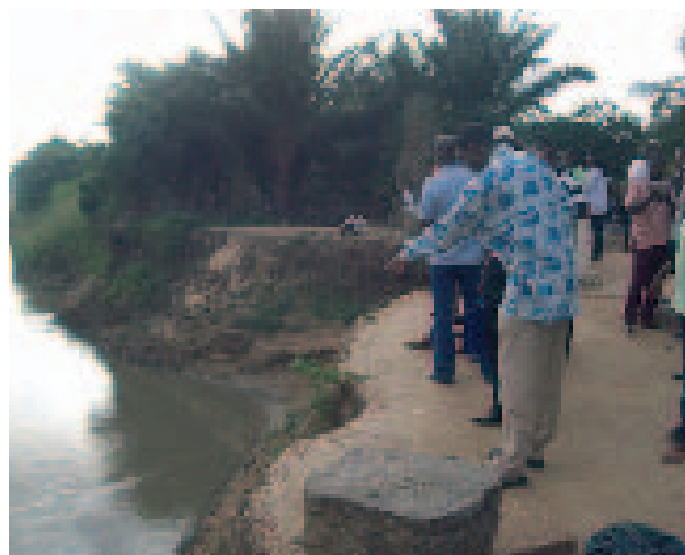
Erosion de la berge au niveau de l'embarcadere à Athiémé
